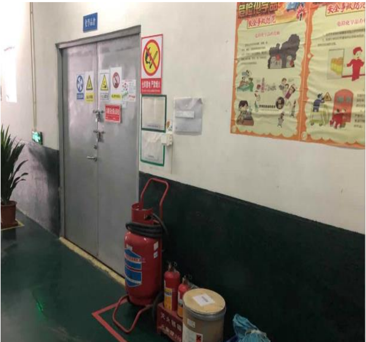
化学品储存区消防器材
